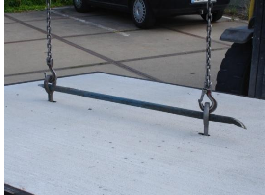
Bild 4: Sicherung der Hubschlüssel
